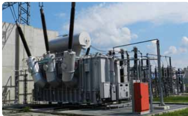
Obr. 2 Trojfázový výkonový transformátor prenosovej sústavy, napätová hladina 400 kV/110 kV, výkon 350 MVA
