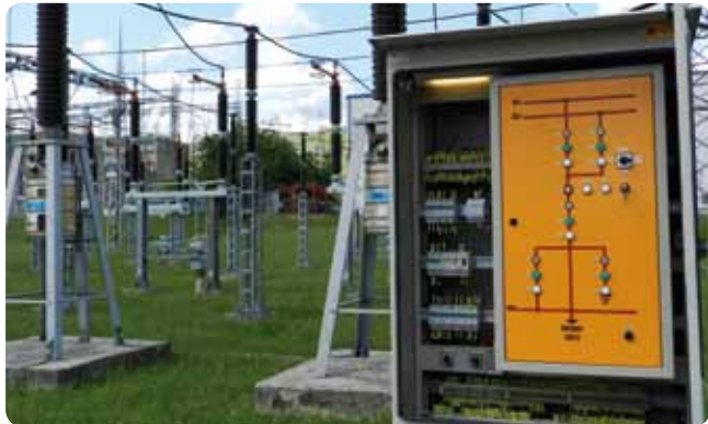
Obr. 3 Ovládacia skriňa poľa vývodu 220 kV (elektrické ovládanie jednotlivých prvkov)
