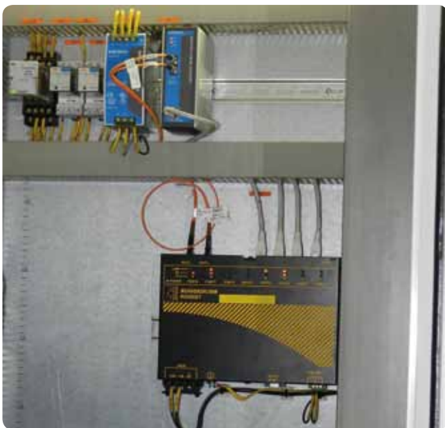
Obr. 5 Komunikačný prevodník RUGGEDCOM. Služi na komunikáciu RIS-u. Komunikácia cez optiku, zber informácií pomocou ethernetu (metalický).
