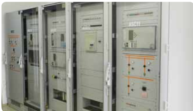
Obr. 7 Domček ochrán R400 kV, zariadenia zľava: núdzová ovládacia schéma poľa ASC12, terminál RIS AWC12 (zber informácií), 1. ochranný terminál ARA12, 2. ochranný terminál ARB12, núdzová ovládacia schéma poľa merania s terminálom RIS ASC11
