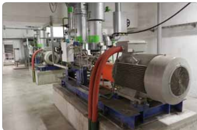
Obr. 1 Napájacie čerpadlá spalínového kotla
