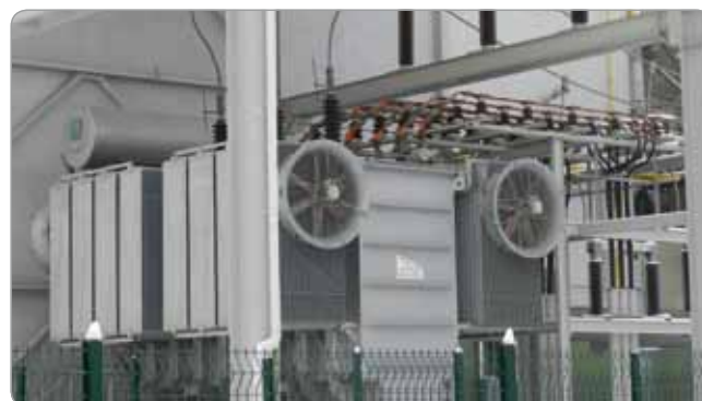
Obr. 4 Transformátor 110 kV/11,5 kV/6,3 kV (80 MVA/63 MVA/16 MVA)
