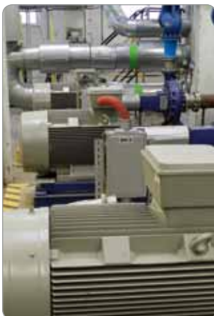
Obr. 8 Obehové čerpadlá horúcovodného systému
