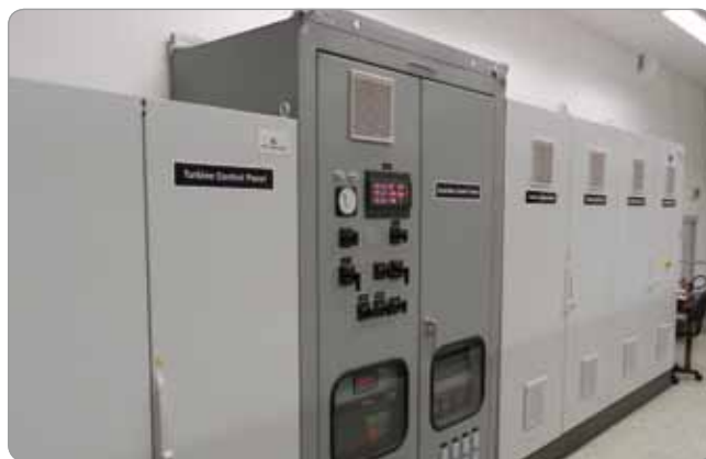
Obr. 6 Riadiaci systém plynovej turbíny v rozvodni DCS
