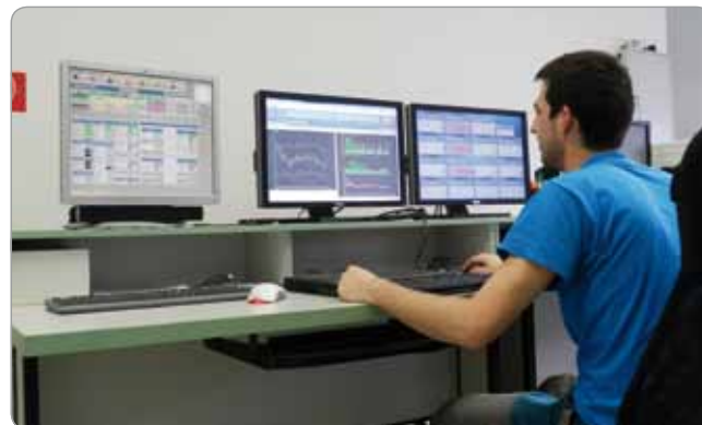
Obr. 11 Systém SKEI inštalovaný v dozorni PPC
