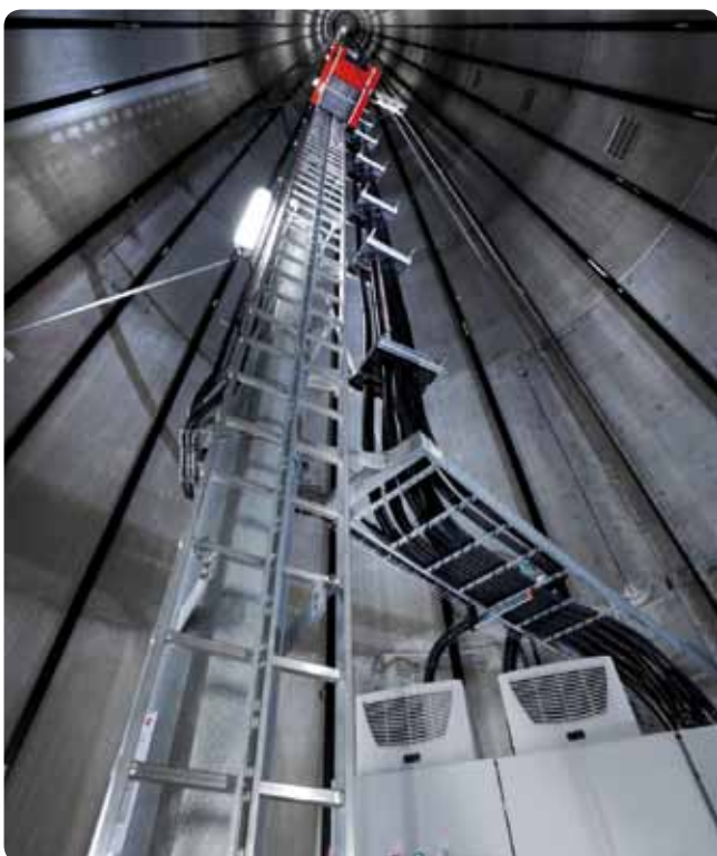
Obr. Pohľad do veže veternej elektrárne s inštalovanými klimatizovanými rozvádzačmi
