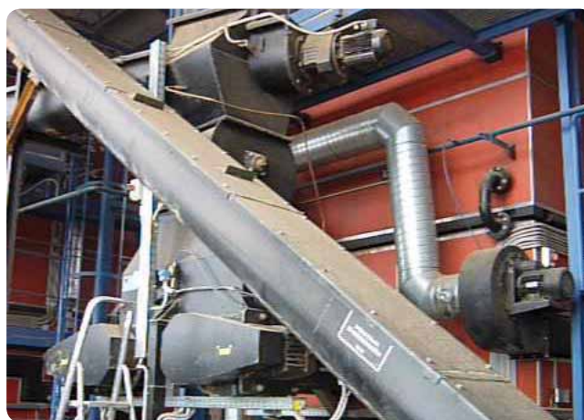
Obr. Kotol na biomasu v kotolni sídliska Juh
