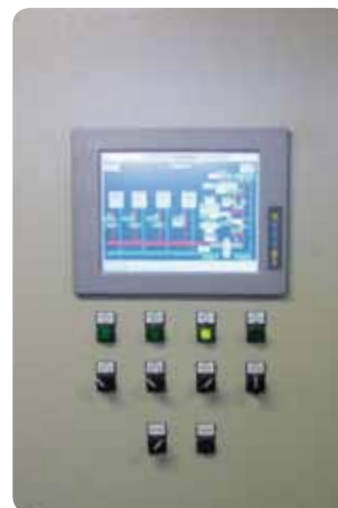
Obr. Dotykový displej na rozvádzači v kotolni sídliska Juh
