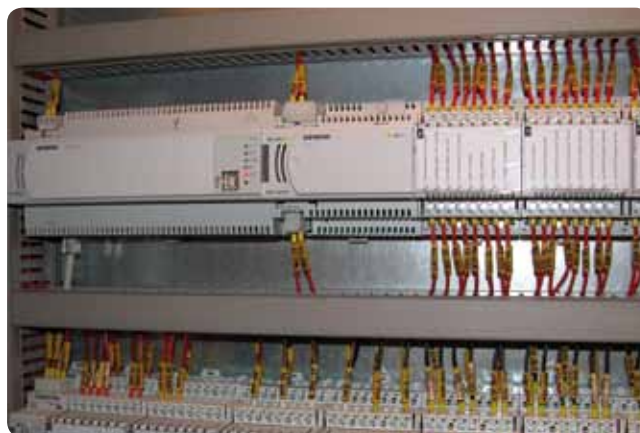
Obr. 6 Riadiaci systém Siemens PXC 100-E.D.
