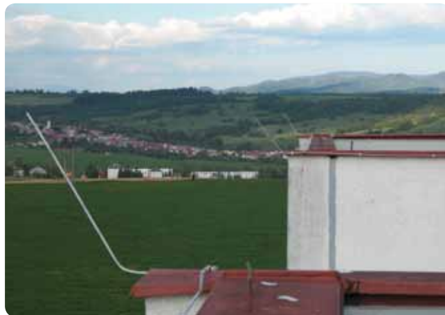
Obr. 2 Vonkajší systém ochrany pred bleskom
