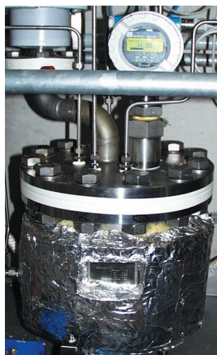
Obr.3 Micropilot M na destilačnej kolóne
