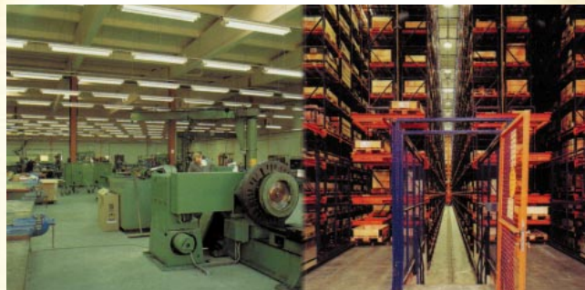
Obr.4 Osvetlenie haly a skladu žiarivkovými svetidlami
