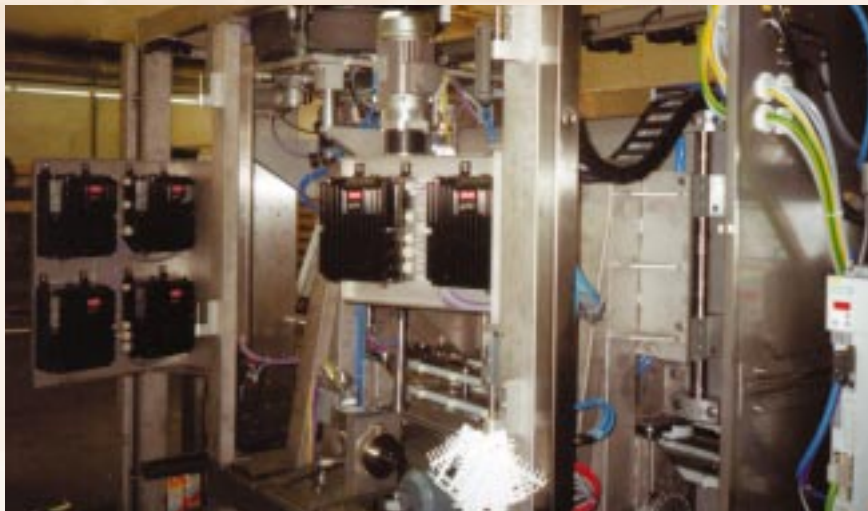
Obr.3 Na ACB systém combifit 15 bolo inštalovaných 6 meničov FCD 300 pre nástennú montáž prehľadne na otočnom ráme. Dolná časť poskytuje veľký priestor na pripojenie
