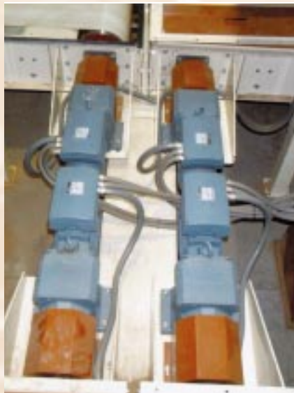
Obr.2 Pohony dopravných pásov sa uskutočňujú prostredníctvom 42 prepojených motorových prevodoviek s meničmi Bauer EtaSolution s rozhraním Profibus a výkonmi na hriadeľ motora v rozsahu od 0,37 do 7,5 kW
