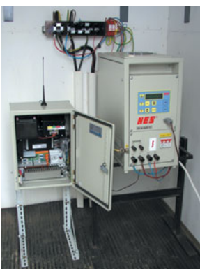
Obr.3 Objekt SKAO s nainštalovaným systémom RaM
