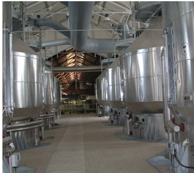
Stanica varostrojov po rekonštrukcii v roku 2003
