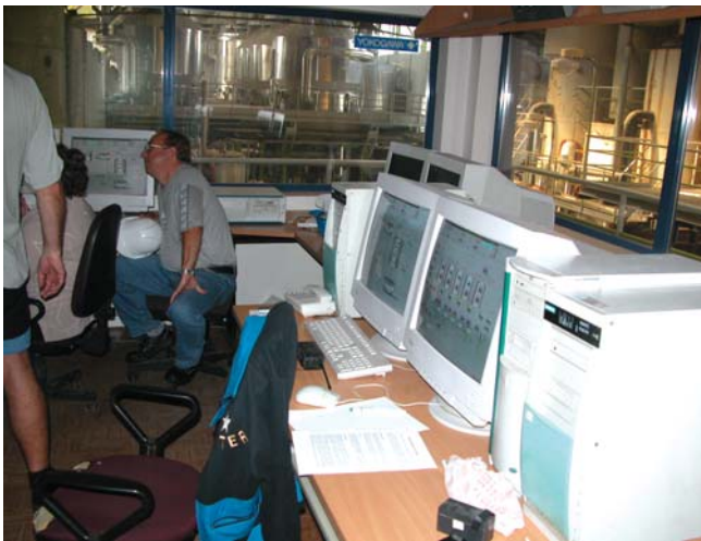
Riadiace centrum (dozorňa) pre surováreň
