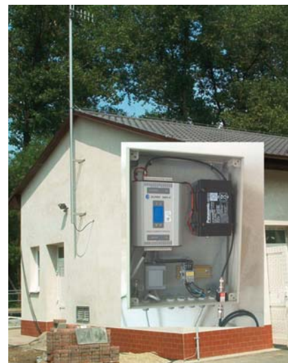
Radiotelemetrická stanice v čistírně odpadních vod
