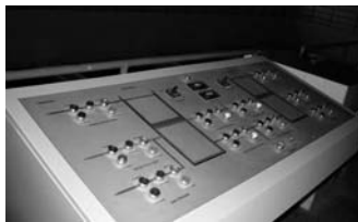
Riadiaci pult filtračnej jednotky ÚV v Hriňovej
