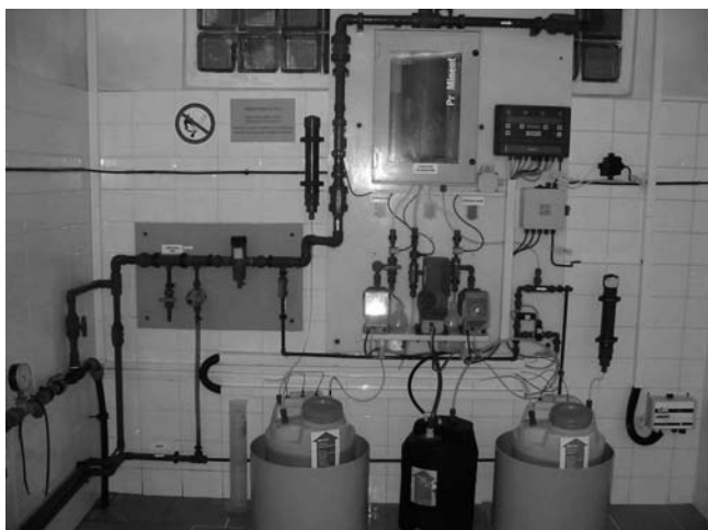
Riadenie dávkovania chemikálií v ÚV Hriňová
