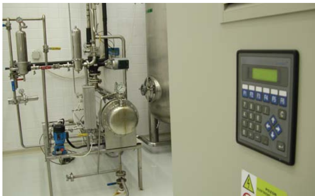
Ovládací panel TECO ID-08 a časť zariadenia sanitácie
