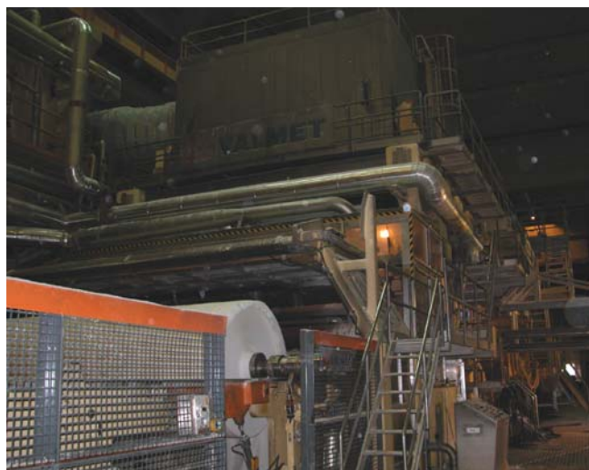
Záverečná časť PS 2 – pohľad na valec Yankee so suchou časťou teplovzdušného krytu a valec pope roller
