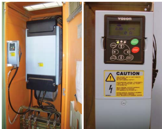
Osadenie nového FM VACON do existujúcej skrine pôvodného FM hlavného pohonu briketovacieho lisu č. 2
