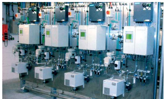
Domec procesných plynových analyzátorov a prípravy vzoriek v zariadení na výrobu kyseliny akrylovej
