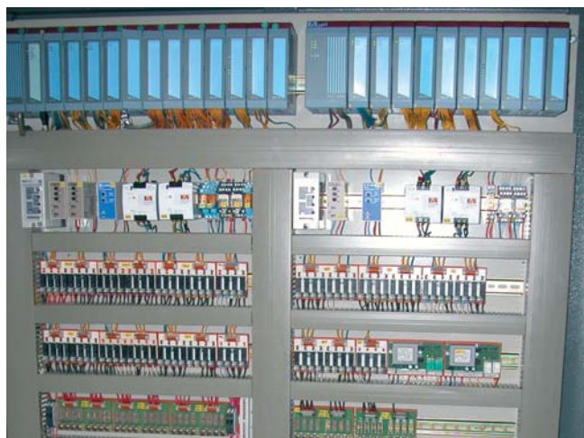
Rozvádzač s riadiacim systémom drevoštiepkového kotla – systém BR2005 s lokálnym expandom vstupov/výstupov
