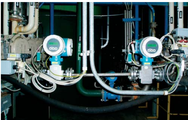
Indukčné prietokomery od spoločnosti Endress + Hauser na dávkovanie médií vo fáze prípravy živných pôd
