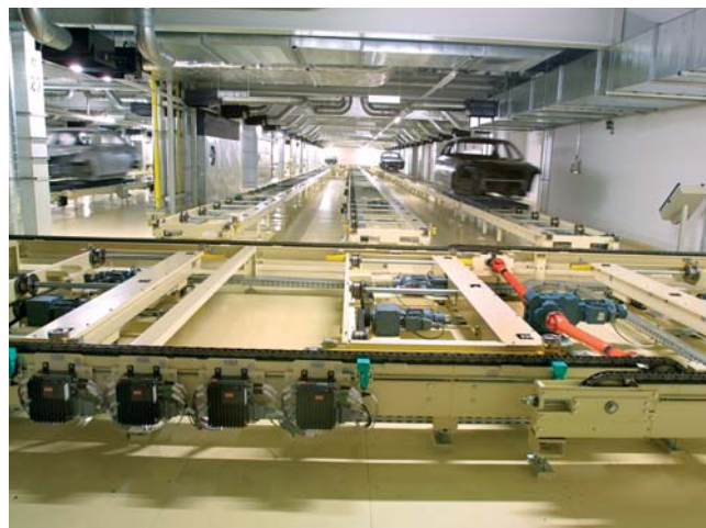
Obr.5 Vystreďovací zdvihač na úseku zaraďovacieho pásového dopravníka na mieste výstupu zo zásobníka. Retazový dopravník je poháňaný motorprevodovkami radu BK a meničmi VLT 5000, vystreďovací stôl motorprevodovkami radu BG a softštartérmí DMS 300
