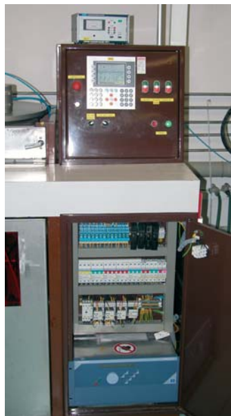
Rozvodná skriňa s panelom PP41 fy. B&R zrekonštruovanej plazmatickej leptačky
