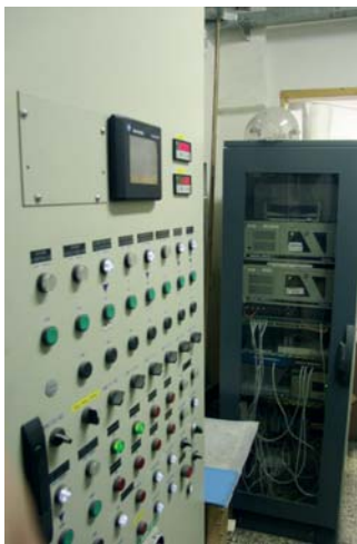
Riadiaci panel taviaceho agregátu a skriňa s priemyselnými počítačmi a komunikačnými rozhraniami
