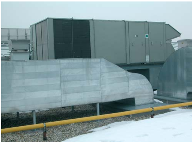
Vzduchotechnická jednotka rooftop
