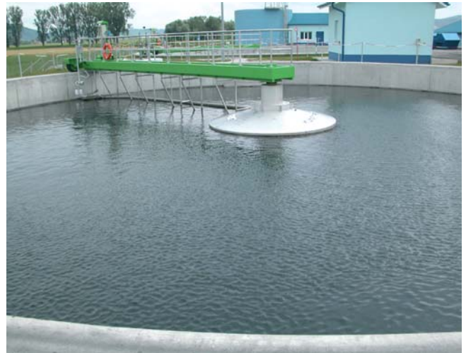
Dosadzovacia nádrž, vpravo čerpacia stanica vratného kalu, v pozadí uskladňovacie nádrže na stabilizáciu kalu
