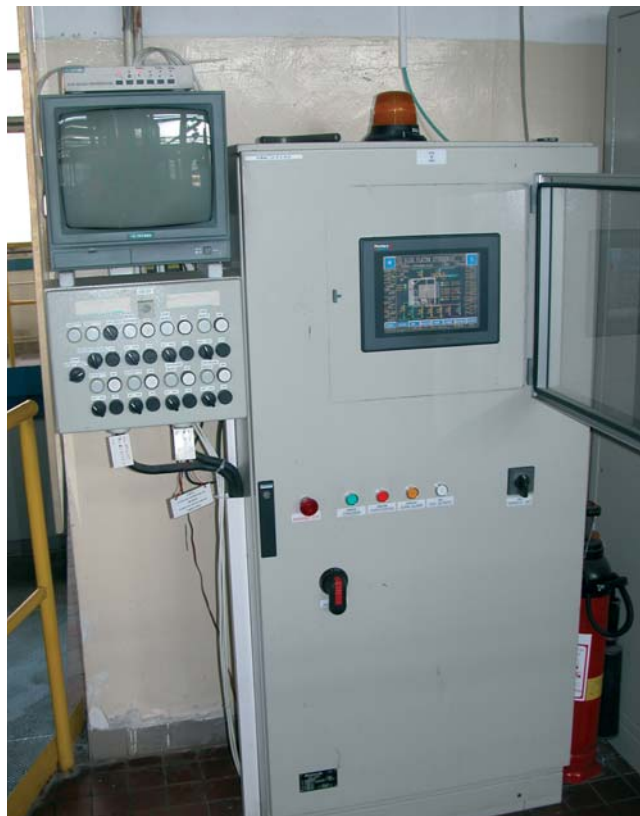
Riadenie filtračnej jednotky
