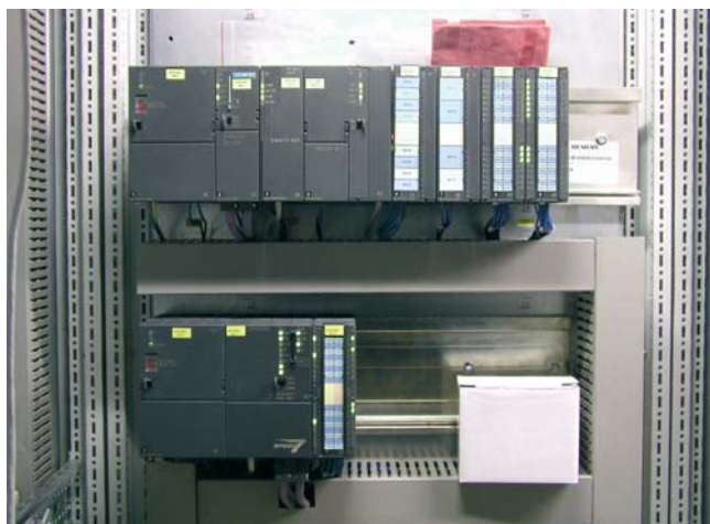
Riadenie v rozvádzači zariadenia: hore nadradené riadenie linky Simatic PLC, dole riadenie vypaľovacieho portálu VIPA PLC
