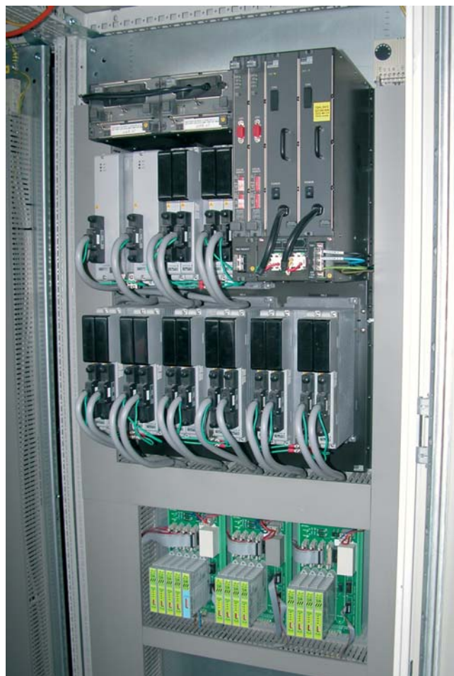
Riadiaci systém Yokogawa CS1000 s diaľkovým prenosom Hart signálov
