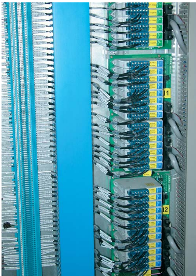
Iskrovo bezpečná časť analógovej meracej skrine osadená zakončovacími doskami (Terminal Boards) s bariérami od firmy MTL (modré sú dvojkanalové AI a zelené jednonakanalové AO)
