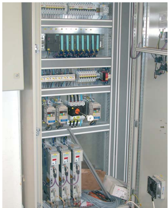
Pohľad na riadiaci systém Simatic S7-300 dopravnej linky DC M-Joy
