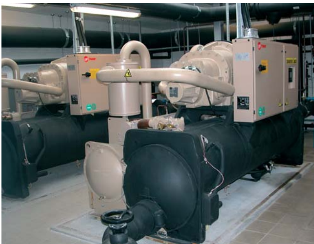
Zdroje chladu Trane v strojovni chladienia bloku B
