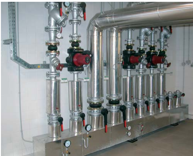
Rozdelovač/zberač vykurovacej vody v kotolni bloku A
