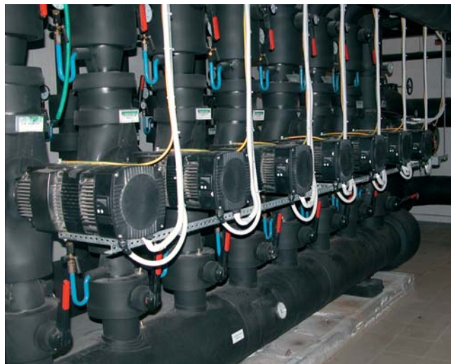
Rozdelovač chladiacej vody s obehovými čerpadlami v strojovni chladienia bloku B
