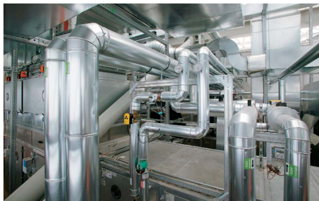
Jedna zo 140 klimatizačných jednotiek štadióna
