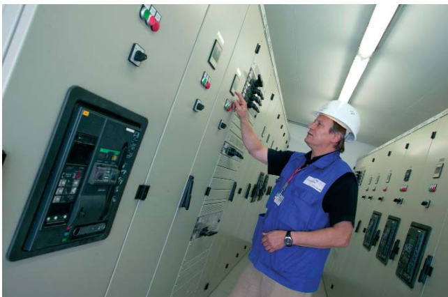
Rozvodňa nízkeho napätia, inštalovaných je celkovo 750 rozvádzačov s celkovým výkonom 12 MW
