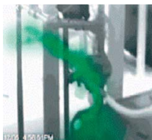
Obr.9 Netěsnost na uzavíracím ventilu
