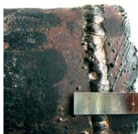
Obr.5 Závada na plynovém potrubí
