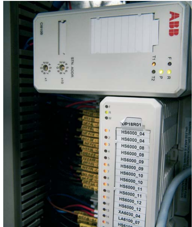
Obr.1 Karty I/O zabezpečujúce riadenie výroby v chemickom závode
