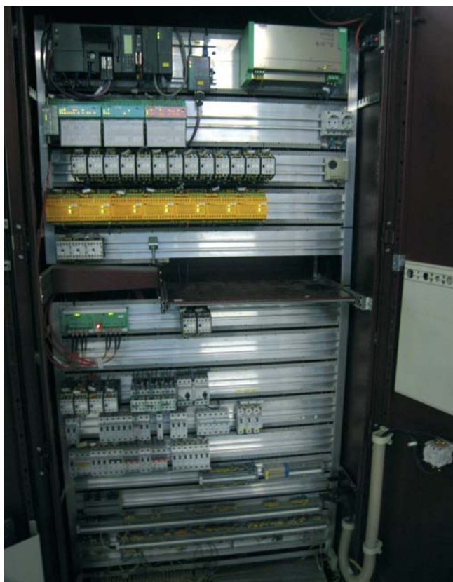
Pohľad na primárny rozvádzač zariadenia s riadením SIMATIC S7 316-2DP
