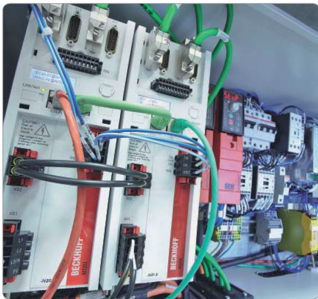
Obr. 3 Pohľad do vnútra riadiaceho rozvádzača – vpredu servopohony EtherCAT AX5000
