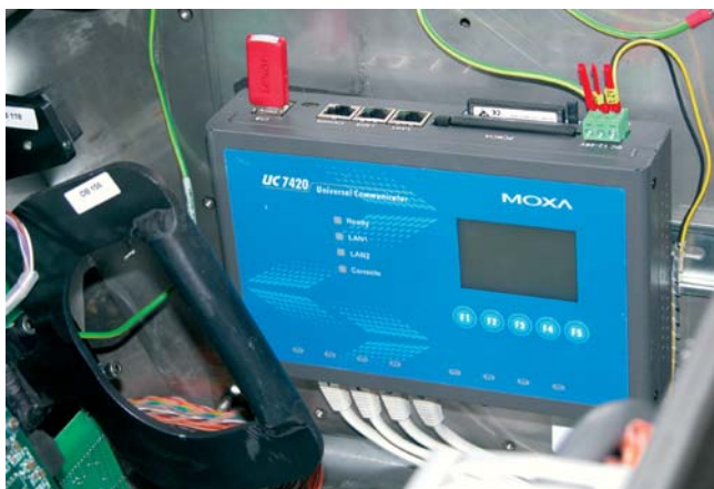
Zabudovaný priemyselný počítač Moxa s operačným systémom Linux zabezpečujúci zmenu parametrov triedenia, uloženie programov, komunikáciu s dotykovým displejom a možnosťou pripojenia k systému SCADA
