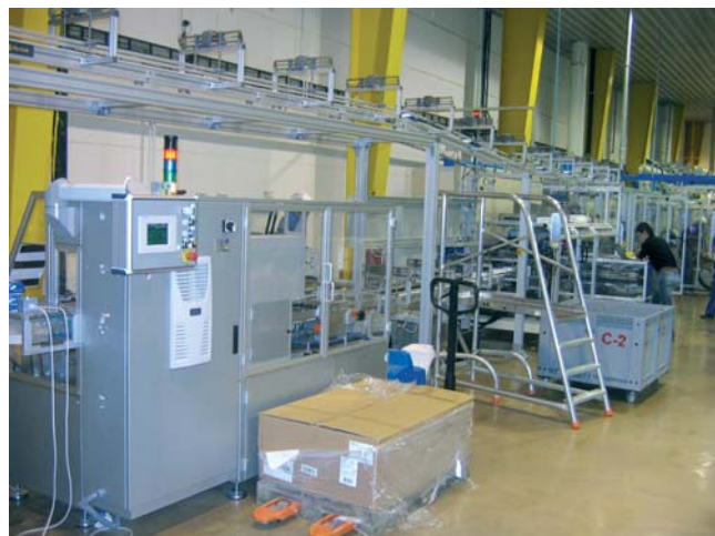
Linka FlexLink s automaticky nastavovateľnými vodičmi lištami a klinovými dopravníkmi inštalovaná v SCA Gemerská Hôrka
