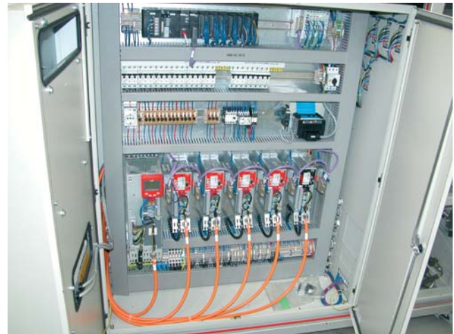
Osadenie rozvádzača pre nástrekovú jednotku – vyššie je riadiaci systém od spoločnosti Omron, nižšie sú meniče frekvencie Lust, medzi ktorými prebieha komunikácia cez Profibus
