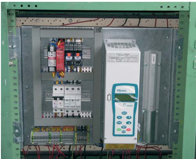
Obr.4 Montážna doska v pôvodnom rozvádzači
