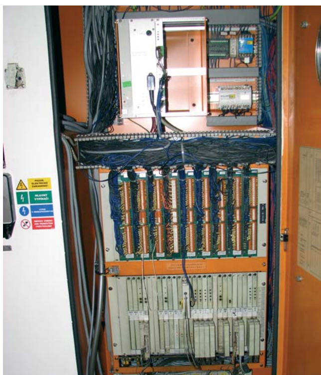
Pohľad na rozvádzač pred vykonaním opravy a výmeny riadiaceho systému a pohonov
