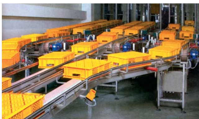
Obr.6 Transportné prepravky sa dopravujú výtahmi do horného poschodia a tam sú zvedené do troch umývacích trás. Transport zabezpečujú pohony od spoločnosti Nord
