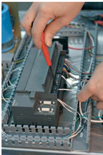
Prepojenie riadiaceho systému
