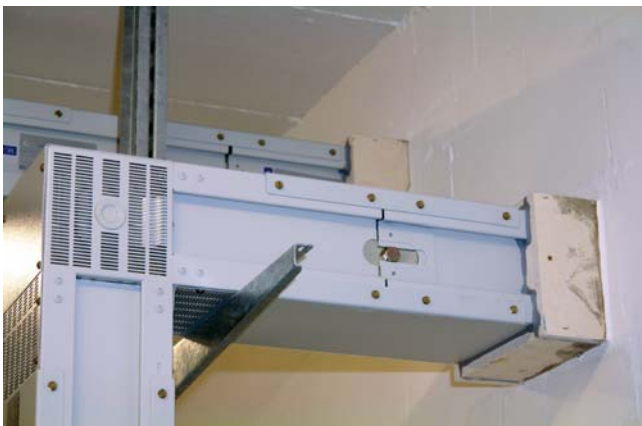
Prípojnicové rozvodné systémy Siemens Sivacon 8PS umožňujú jednoduché a účinné protipožiarne oddelenie, ako to vidieť na príklade prípojnice Siemens typu LD
