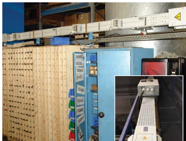
Obrovskou výhodou prípojnicových rozvodných systémov je ich flexibilita. Jednotlivé odbočky možno zasúvať a opäť vyťahovať so štandardným rozstupom 0,5, resp. 1 m. To umožňuje kedykoľvek rýchle a individuálne prispôbenie napájaných strojov a agregátov novým požiadavkám
