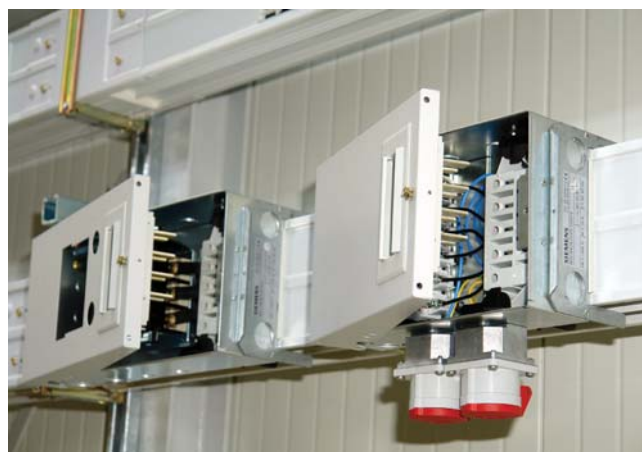
Pri systéme BD2 možno odbočky osadiť príslušnými spínacími a ochrannými prvkami a následne nasadiť na prípojnicový systém dokonca pod napätím. Pritom však treba dbať na lokálne platné predpisy a normy (Nemecko: DIN EN 50110-1 (VDE 0105-1))
