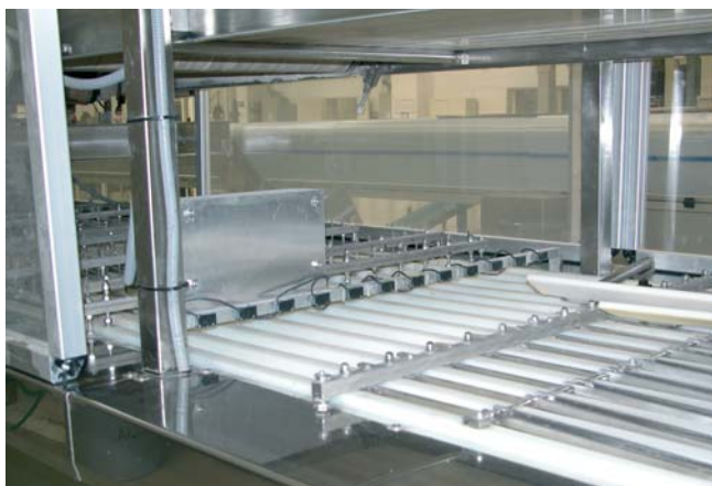
Optické snímače monitorujúce zaplnenie dráh
