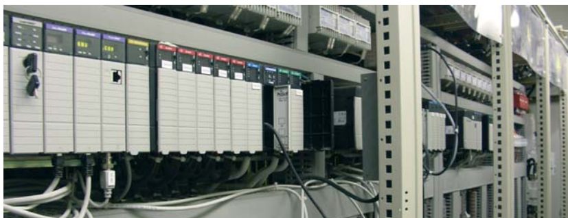
Řídicí systém dokáže spouštět a zastavovat strojní zařízení mlýnu a umožňuje profitovat ze snížených tarifů za elektřinu
