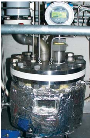
Obr.2 Micropilot M na destilačnej kolóne
