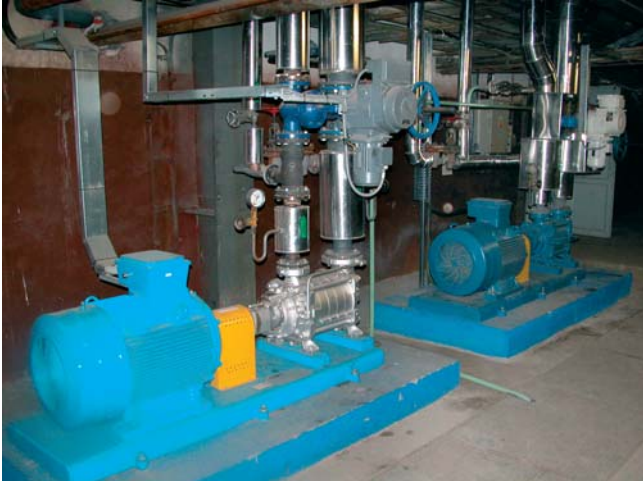
Napájacie čerpadlá kotlovej vody
