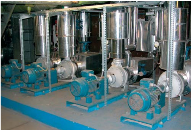
Pohľad na obehové čerpadlá kotla K7 – úroveň 0,00 m
