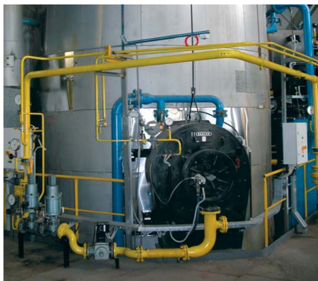
Pohľad na horák SAACKE kotol K6 - úroveň +5 m
