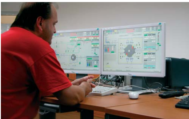
Riadiaci počítač kotla K6 – kurič operátor sleduje parametre kotla
