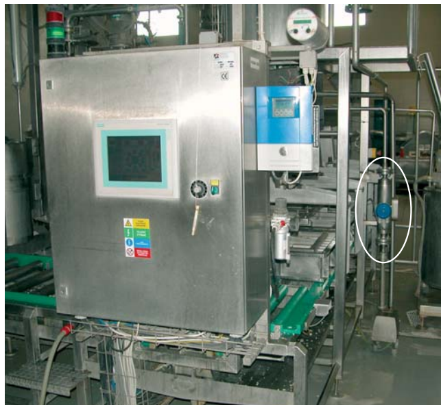
Riadiaci systém Simatic s obslužným panelom na riadenie zrážacieho a lisovacieho automatu. Vpravo vidno Coriolisov prietokomer od firmy Krohne
