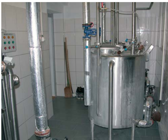
Sanitačná (CIP) stanica
