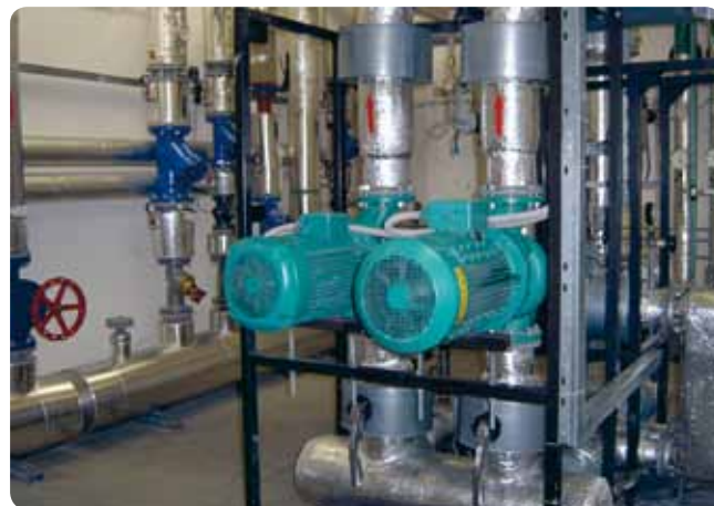
Technológia stanice odovzdávania tepla, konkrétne hlavné obehové čerpadlá ústredného kúrenia v objekte
