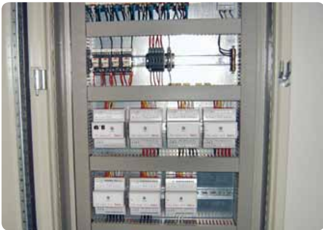
Pohľad na rozvádzač s riadiacim systémom ovládania technológie výroby chladu
