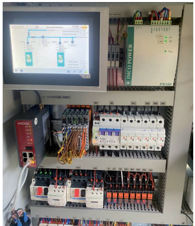
Úpravňa vody využíva na riadenie chodu technológií moderné priemyselné PC spoločnosti B&R.
