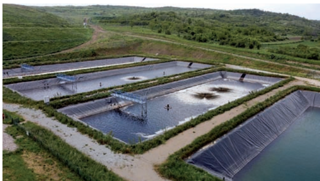
Záhytné bazény slúžia na filtrovanie a čistenie odtoku kontaminovanej vody.
