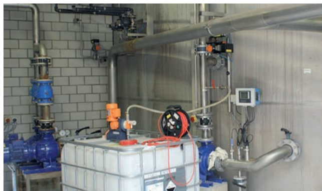
Liquiline CM44 zabezpečujú, že namerané hodnoty sa prenášajú do miestnosti riadenia.
